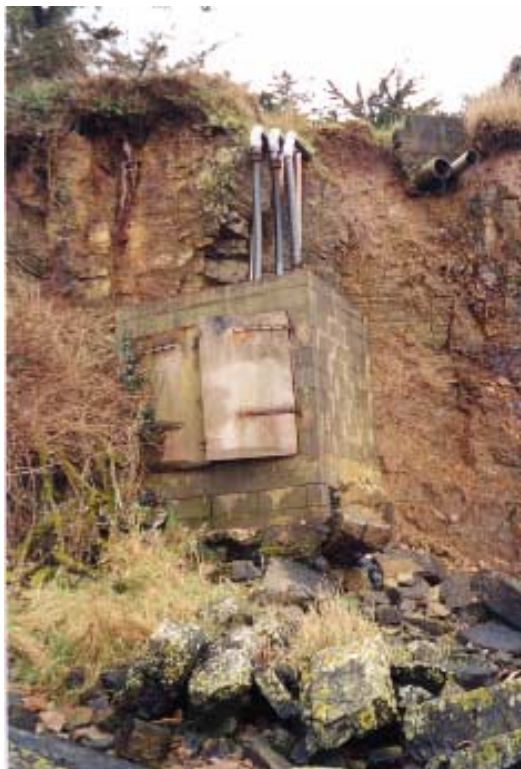
Photo 3 : abri pour système de pompage d'un chantier du Scal (photo M.Philippe, mars 2003)
